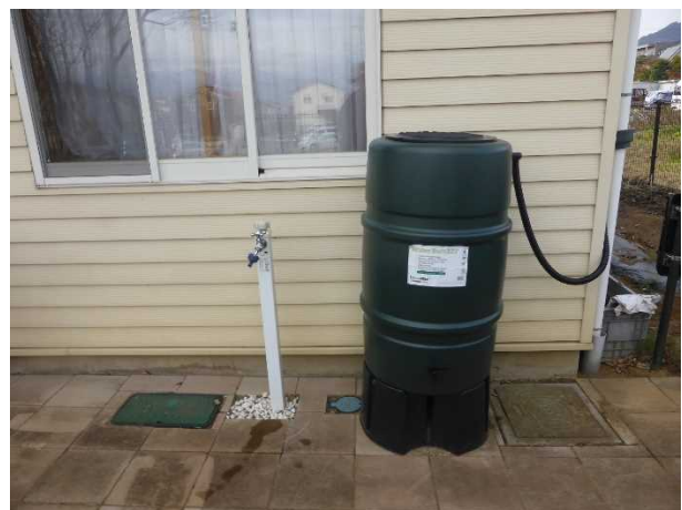
・立柱散水栓と雨水タンク
